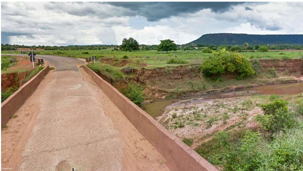
Figura nº 39 Erosão e assoreamento do leito do córrego afluente do rio Piauí, imediatamente a montante da cidade de Santa Rosa do Piauí. Destacam-se: 1- as ravinas profundas nas cabeceiras da ponte, induzidas pelo escoamento das águas da chuva pelo leito da rodovia, direcionadas para os terrenos laterais sem sistema algum de proteção; 2- Erosão lateral das margens do córrego totalmente desprovidas da vegetação ciliar original; e 3- bancos de areia assoreando o leito do córrego. (Street View, 02/2012)
