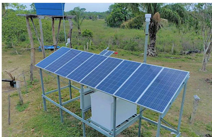
Figura Nº 11: Exemplo placas fotovoltaicas instaladas na zona rural.
